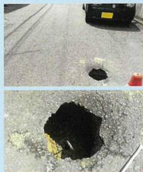
道路陥没の様子
